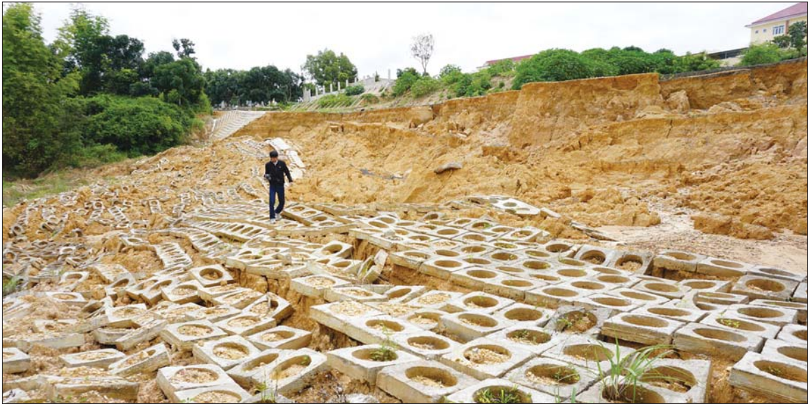
Dự án Kè chống sạt lở Quốc lộ 24 đoạn qua phường Duy Tân (TP. Kon Tum) đang “đắp chiếu” đợi vốn thì bị sạt lở sau trận mưa
